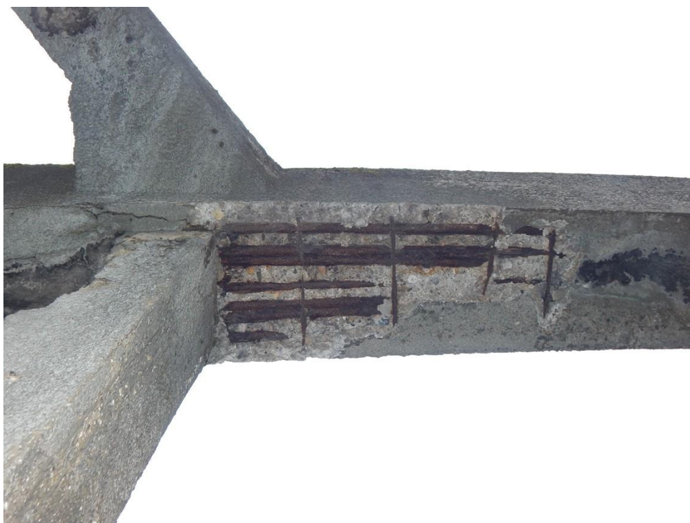
Fot. 6. Uszkodzenia j.w.
