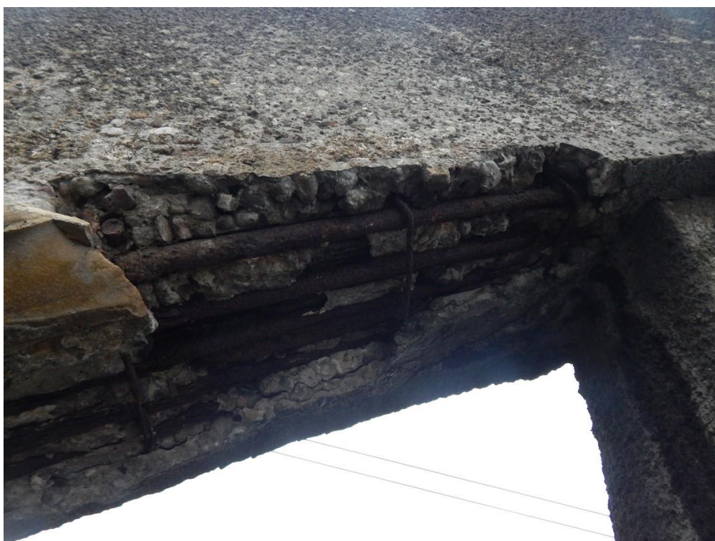
Fot. 8. Korozja betonu i stali zbrojeniowej w dźwigarach betonowych
