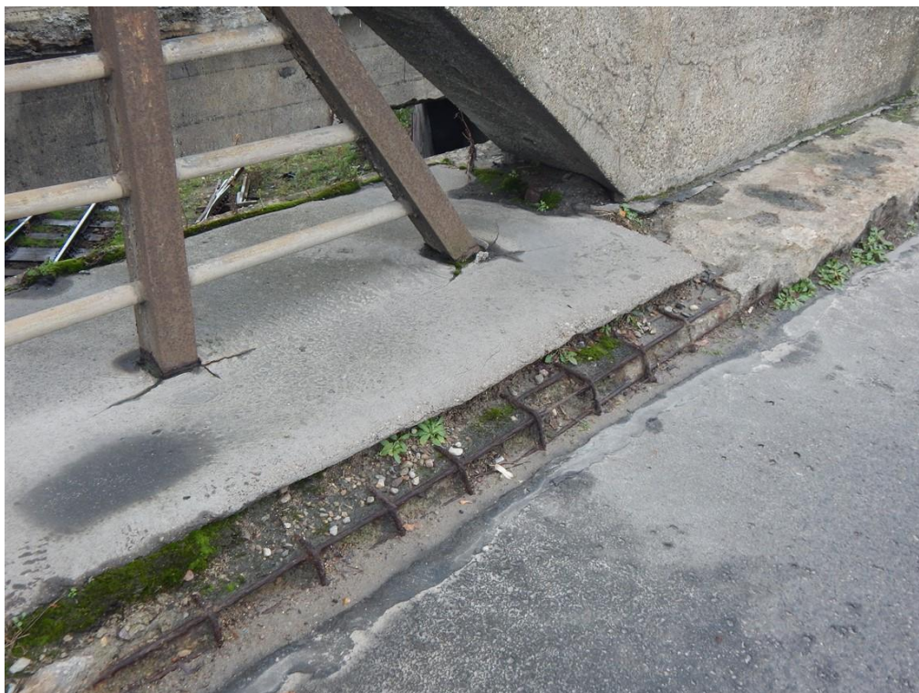
Fot. 11. Ubytki betonu w profilu krawężnika
