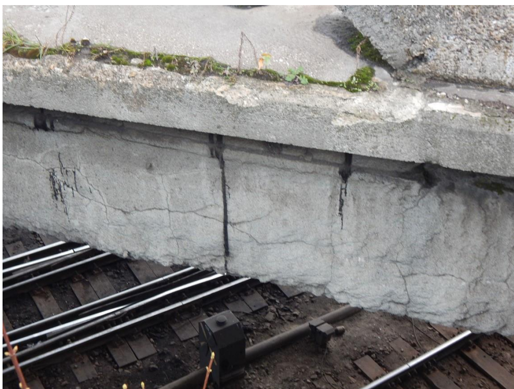
Fot. 10. Ubytki betonu, rysy w elementach gzymsów
