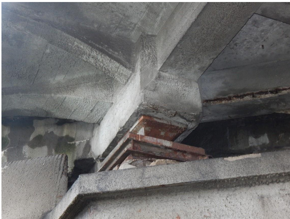
Fot. 24. Uszkodzenia j.w.
