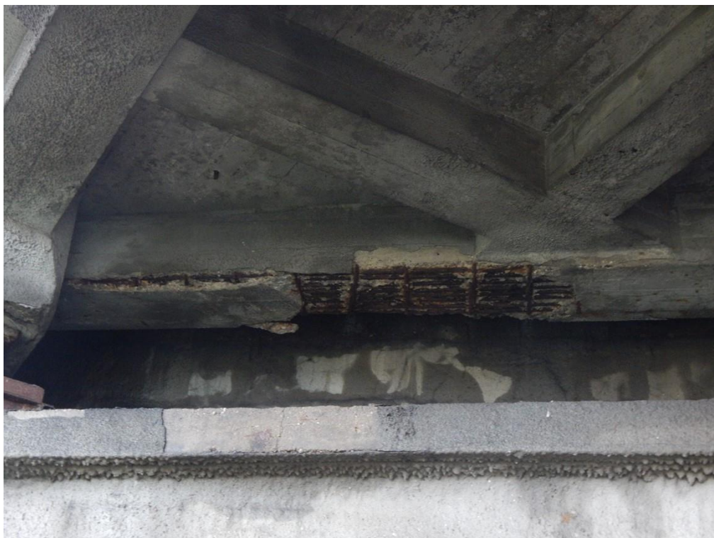
Fot. 19. Ubytki betonu oraz korozja stali zbrojeniowej w poprzecznicy dźwigarów
