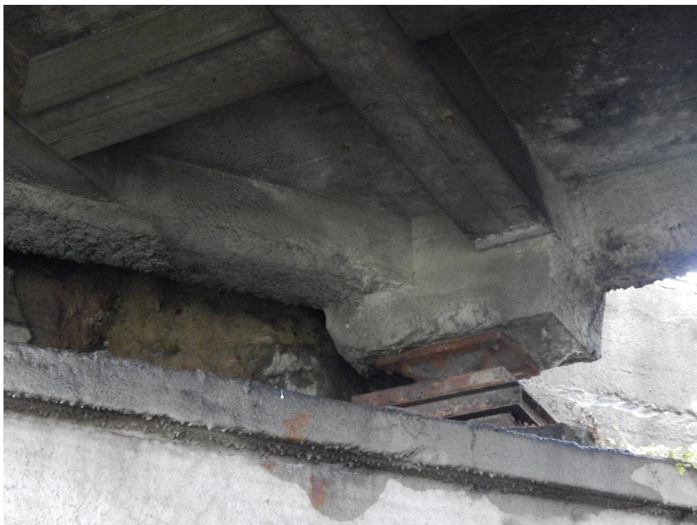
Fot. 15. Uszkodzenia j.w.
