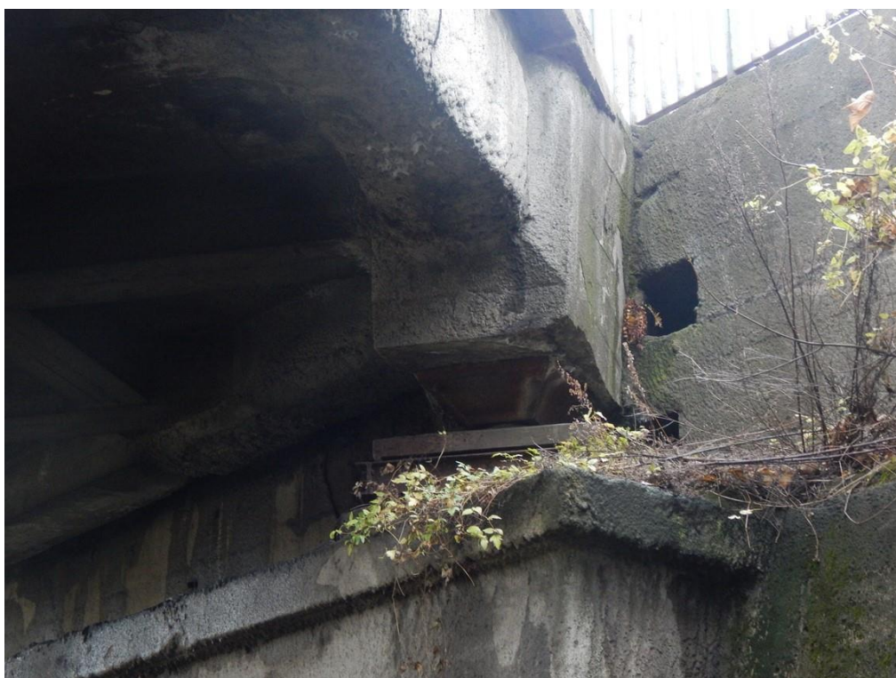
Fot. 16. Uszkodzenia j.w.
