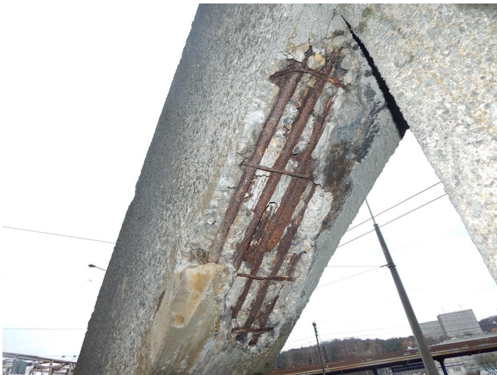
Fot. 5. Ubytki betonu oraz korozja stali zbrojeniowej w elementach dźwigarów betonowych
