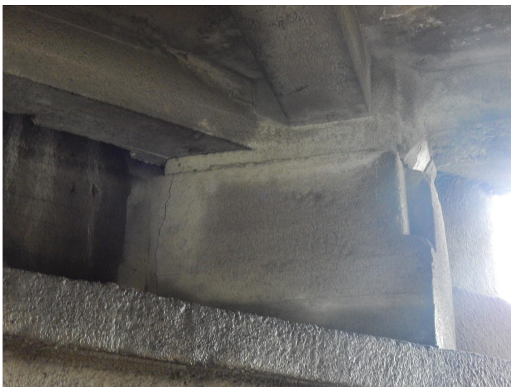
Fot. 18. Rysy i spękania w ciosach podłożyskowych
