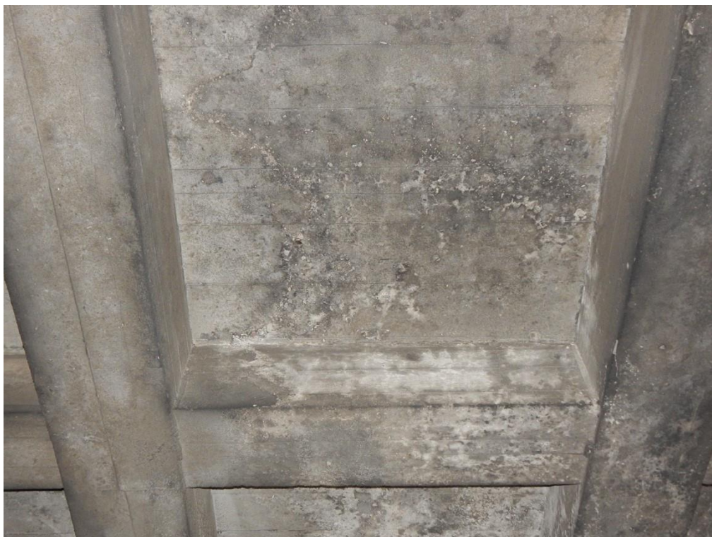
Fot. 22. Uszkodzenia j.w.
