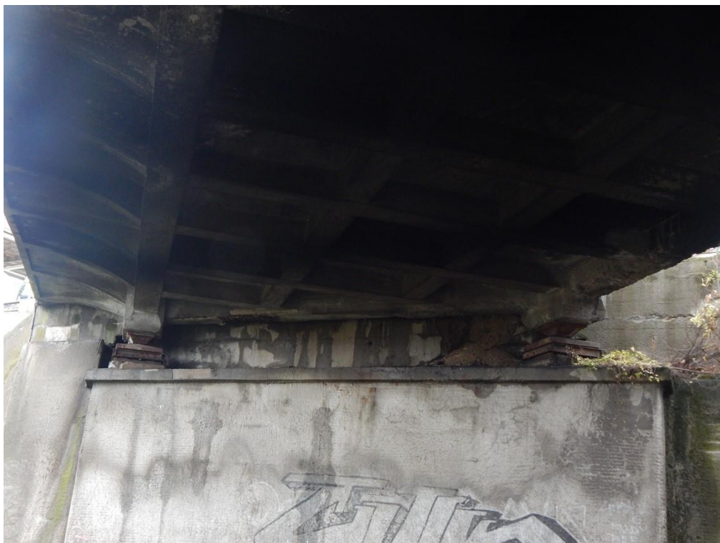
Fot. 13. Graffiti na przyczółku, widoczne przecieki przez dylatacje
