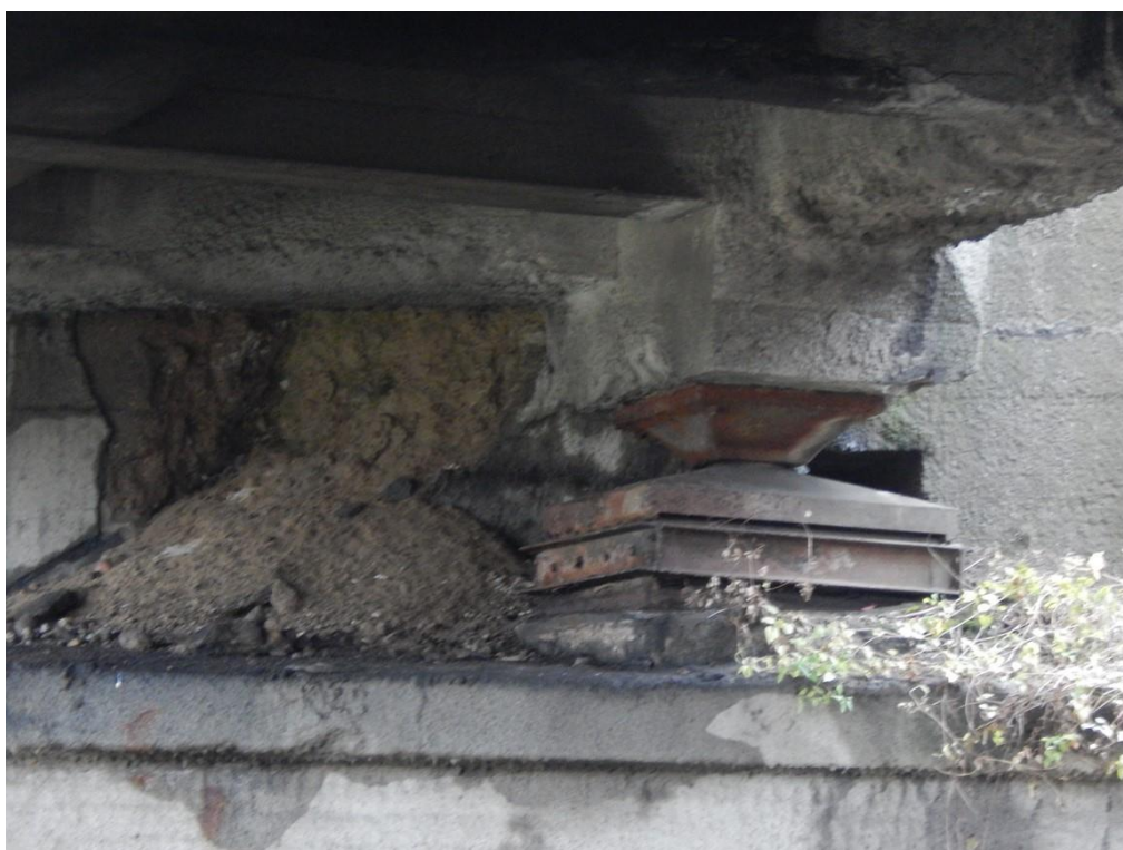
Fot. 14. Uszkodzenie ścianki zapleczej, blokada pracy ustroju nośnego i brak możliwości przesuwu
