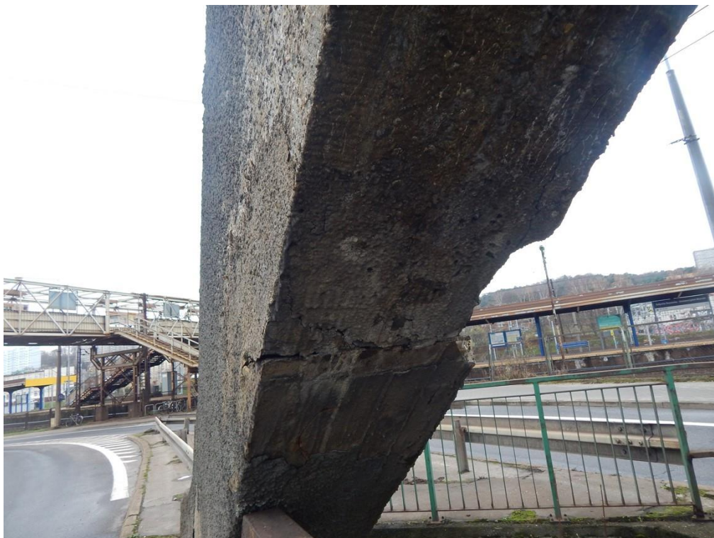
Fot. 7. Spękania i rysy w elementach dźwigarów betonowych
