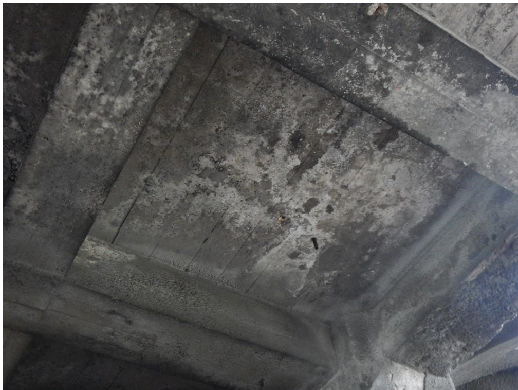
Fot. 21. Przecieki przez konstrukcję pomostu
