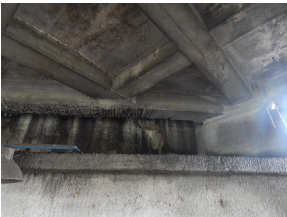
Fot. 20. Widoczne przecieki przez konstrukcję dylatacji
