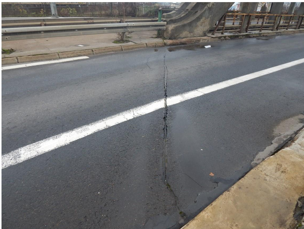
Fot. 3. Rysy, deformacja nawierzchni i ubytki masy bitumicznej w miejscu dylatacji
