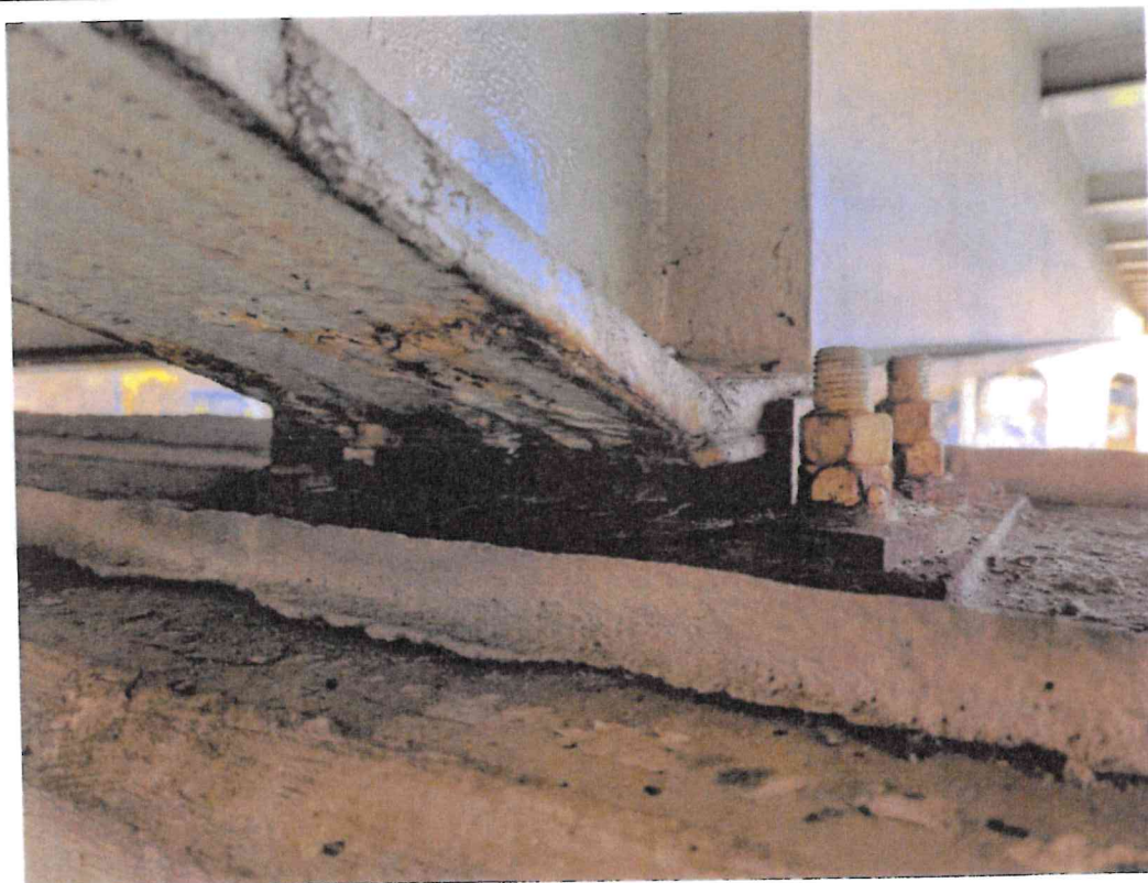
Fot. 14 Rozległa korozja łożyska i pasa dolnego dźwigara kładki.
