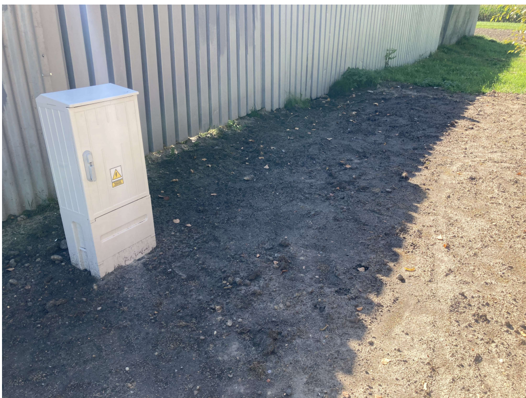
Fot. 10 Widok zewnętrznej rozdzielni energetycznej od strony wiaty piknikowej
