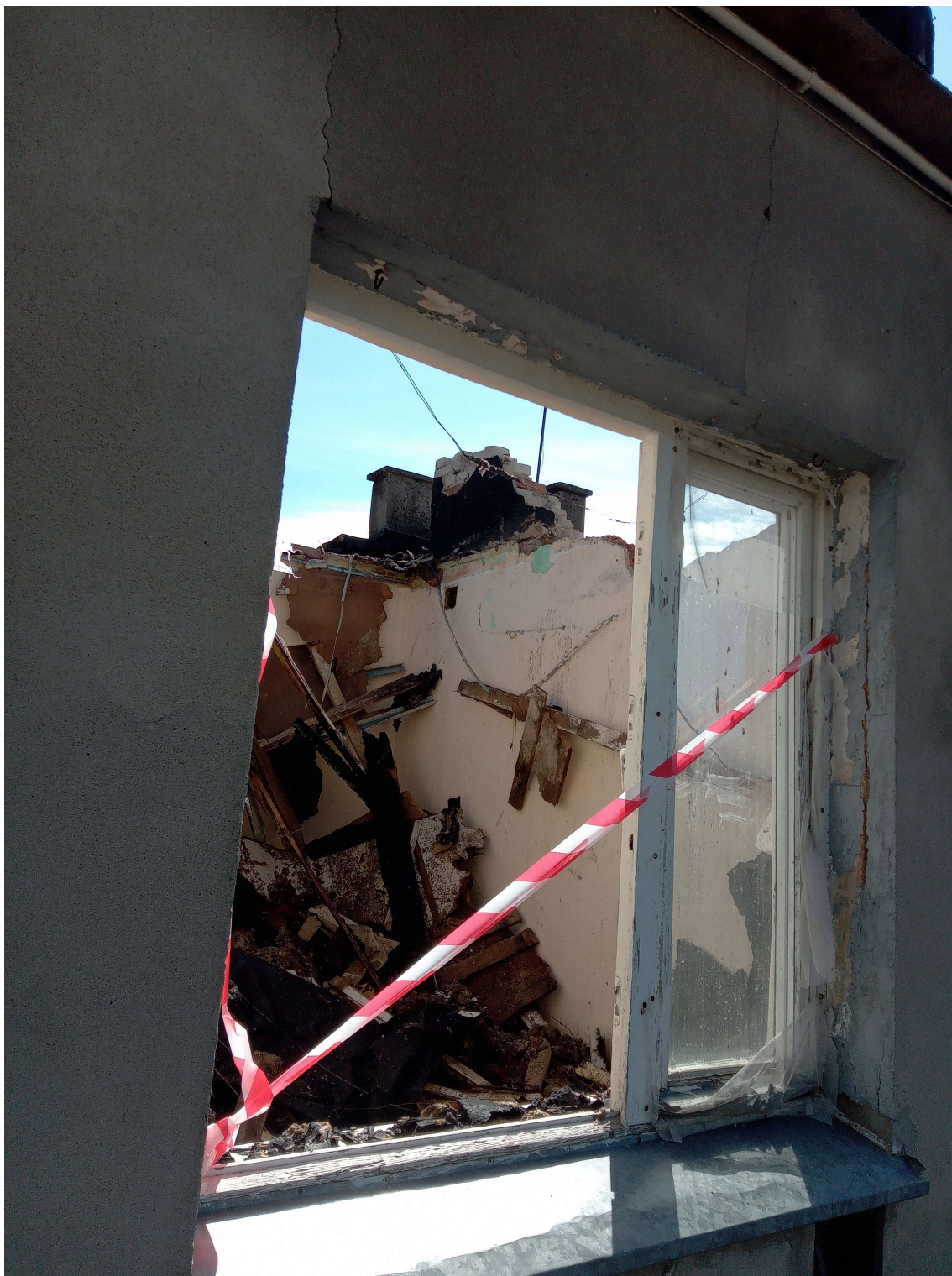
Fot.14 Zniszczona i pognita stolarka okienna
