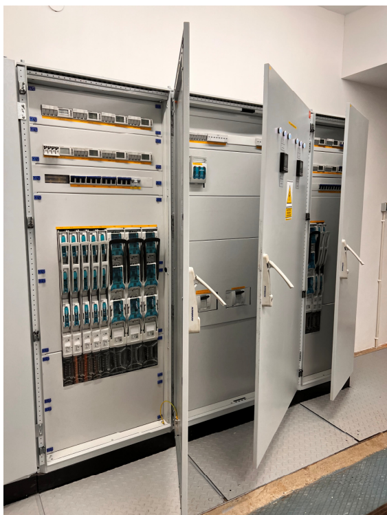
Fot.4. Wnętrze istniejącej Rozdzielni
