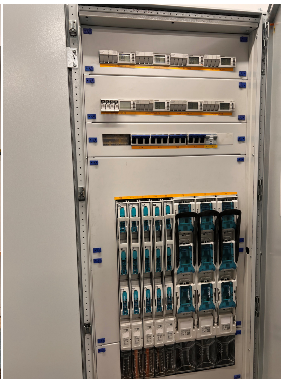
Fot.5. Wnętrze istniejącej Rozdzielni
