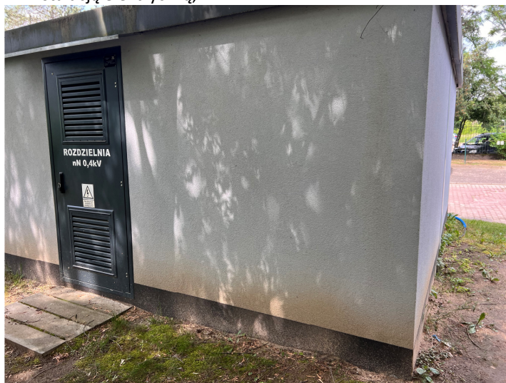
Fot. 2. Istniejącą trafostacja (Bud. „P”)
