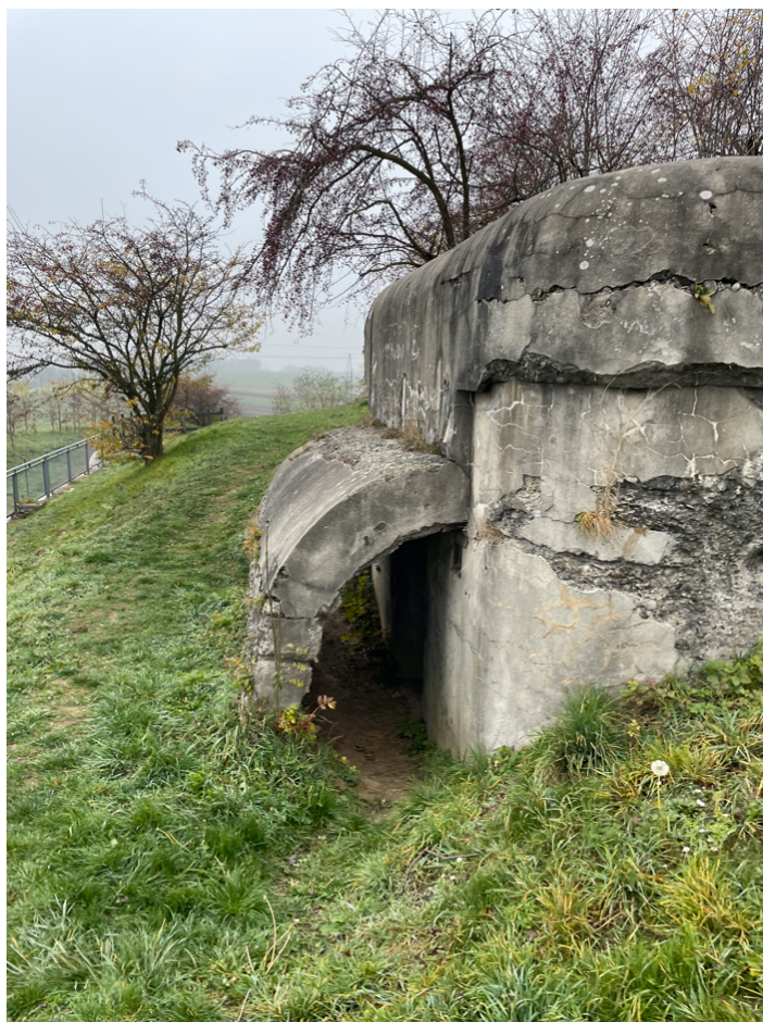
Fot. Przelotnia schronu zlokalizowanego na lewostronnym wale koszar, widoczne spękania konstrukcji
