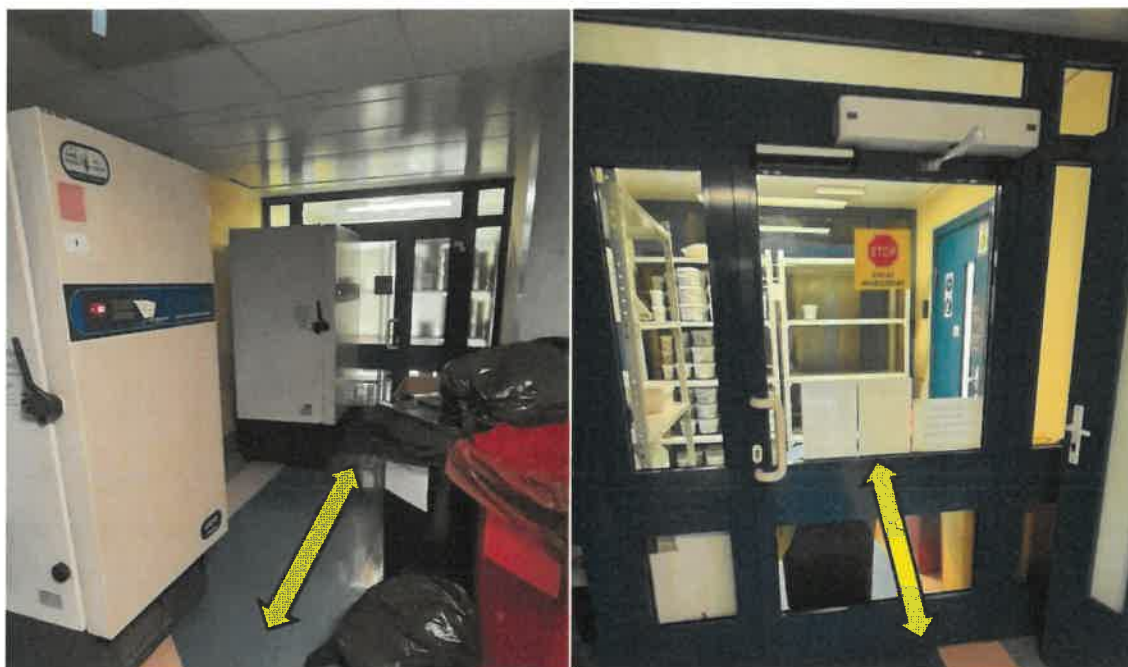
Fot. 21,22. Piętro 1. Zablokowana ewakuacja pomiędzy oddziałem: centralne laboratorium, pracownia patomorfologiczna. Zapewnić obustronną ewakuację, oraz usunąć miejsce składowania odpadów na drodze ewakuacyjnej. Źródło własne.
