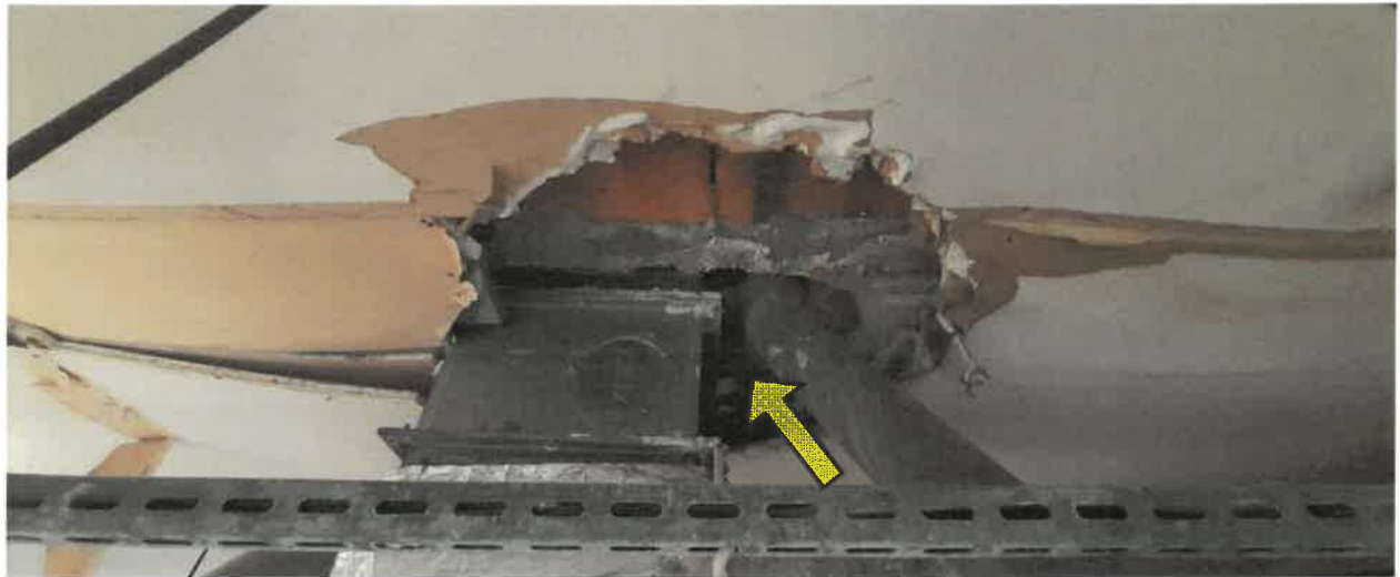
Fot. 32. Przejścia w maszynowni – istniejące przejścia uszczelnić materiałem niepalnym. Źródło własne.
