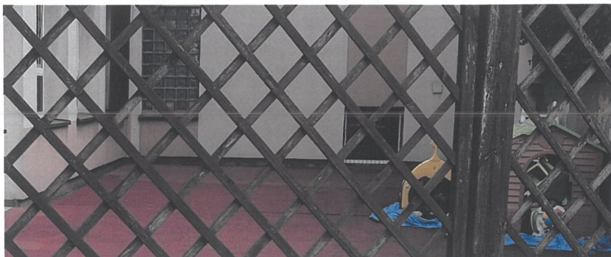
Rys. 14 Widok miejsca w którym istnieje konieczność wykonania hydroizolacji i ocieplenia ścian piwnicznych budynku przylegających do placu zabaw.
