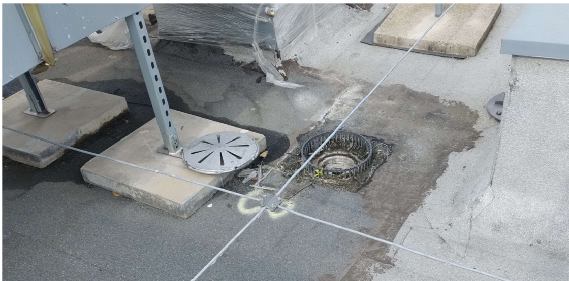
Dach wysoki – połać D1: ciekący wpust w osiach C i 2
