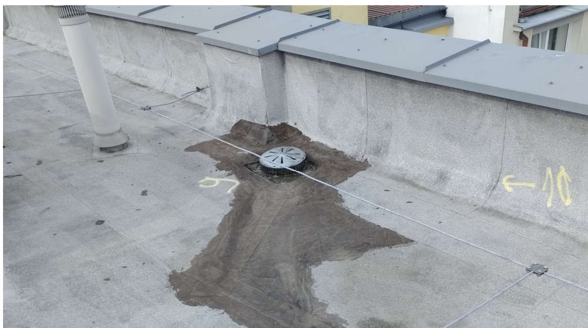
Dach wysoki – połącz D1: ciekący wpust w osiach D i 2
