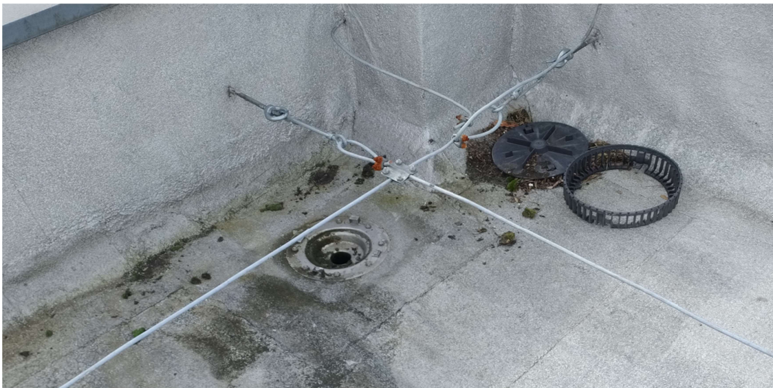
Dach wysoki – połać D1: ciekący wpust w osiach A i 4
